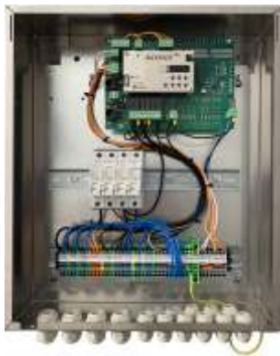
Cuadro eléctrico abierto
