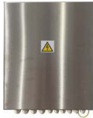
Cuadro eléctrico cerrado
